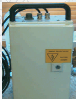
Источник питания 30 В / контроллер контактора
